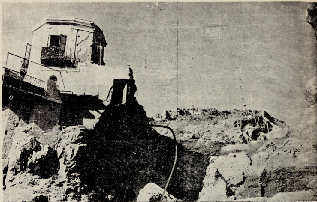
Il villino Caiafa: nella foto si nota la parte abbattuta dalla frana discesa dal M. S. Liberatore. (Foto Vito Alfinito - Fratte di Salerno)
