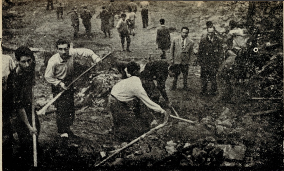
La squadra di operai del Comune di Salerno sgombera la strada a Canalone.
